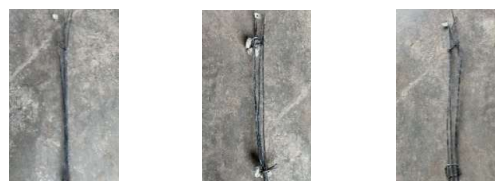
(ก) คอนกรีตผสมน้ำคลอไรด์ (ข) คอนกรีตทาสารกันซึม (ค) คอนกรีตผสมน้ำปกติ รูปที่ 4.1 ลักษณะของเหล็กเสริมในระยะเวลา 6 เดือน
