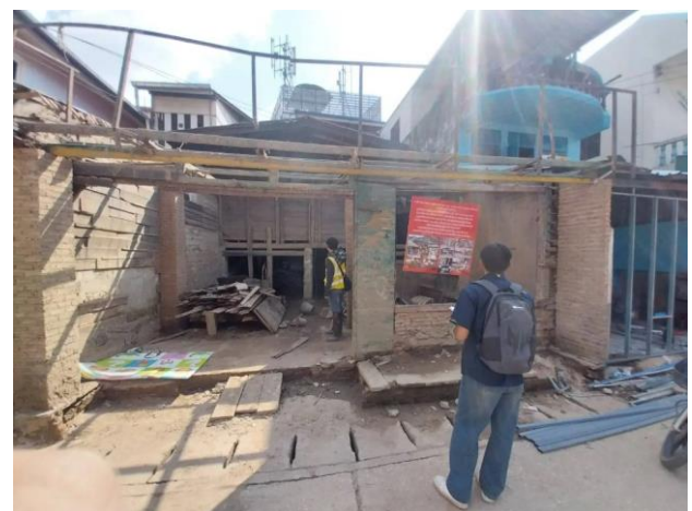
รูปที่ 3 ภาพความเสียหายบ้านหลังหลัง ระดับความเสียหายมาก
