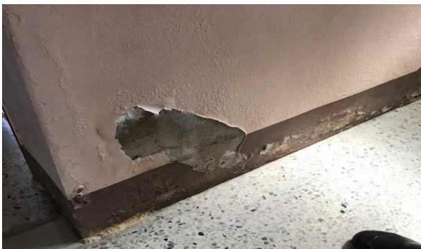
รูปที่ 5 ภาพความเสียหายบ้านหลังหลัง ระดับความเสียหายน้อย
